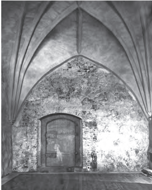
Fig. 5. Den västra delen av sakristians sydoägg. Foto K. Kiviranta 1923. Museiverkets bildsamlingar, Helsingfors.
