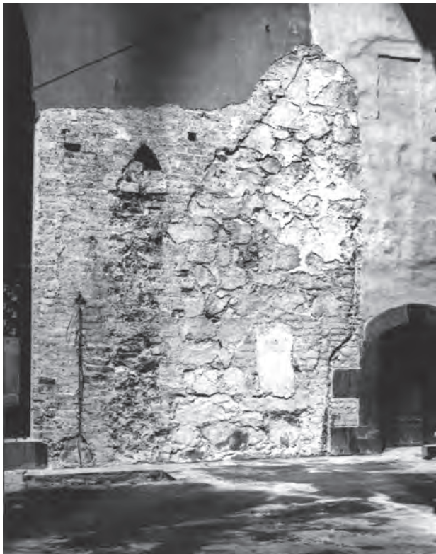
Fig. 2. Långhusets norra vägg. Spår av en bortbruten tegelpilaster och den västra delen av gavelmuren i en äldre gråstenssakristia. Foto: K. Kiviranta 1926. Museiverkets bildsamlingar, Helsingfors.
