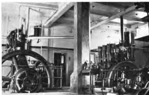
Interior fra Tørring Elektricitetsværk.
